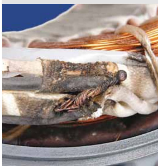
Curto na conexão
